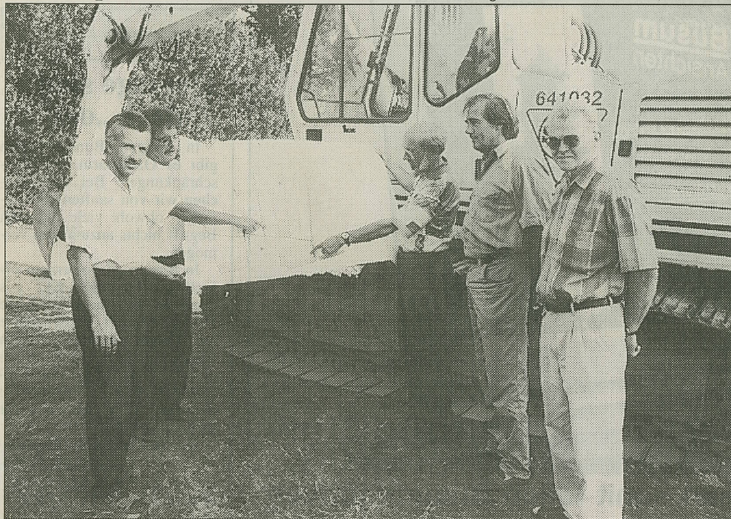
Hier läßt es sich einmal gut wohnen, meinen die beim ersten Spatenstich für das neue Baugebiet Anwesenden. Das waren (von links): Alfred Heydrich, Firma SAW, Bürgermeister Karsten Jasper, Ralf Matthes, Ingenieurbüro Bornholdt, Jochen Hachmann, Firma Hachmann, und der stellvertretende Bürgermeister Günter Ramke. (Foto: Höfer)
